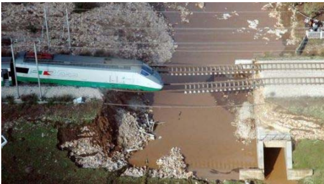
Fig. 12. La piena formatasi nella notte tra il 22 e il 23 ottobre 2005 ha interessato anche la rete idrografica minore. In questa foto si vede a destra in basso un tombino la cui sezione è risultata insufficiente per contenere la portata di piena per cui la corrente si è creato a fianco un varco dove per poco non è precipitato l'Eurostar.
